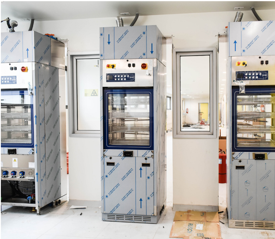
AUTOCLAVES CENTRAL DE ESTERILIZACIÓN
