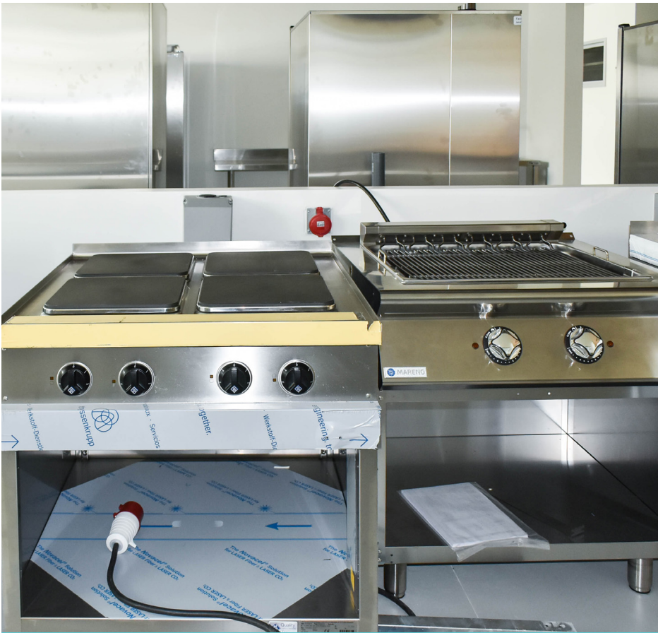
ANAFE Y PARRILLA GRILL CENTRAL DE ALIMENTACIÓN
