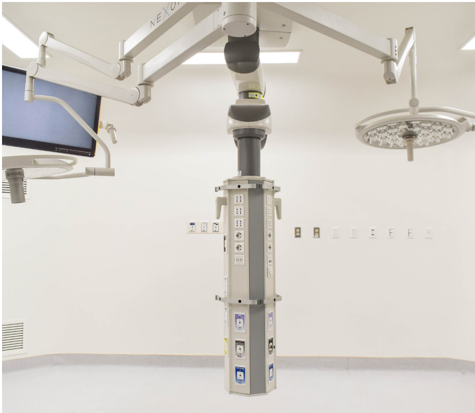
EQUIPO PABELLÓN INTEGRADO PABELLONES QUIRÚRGICOS
