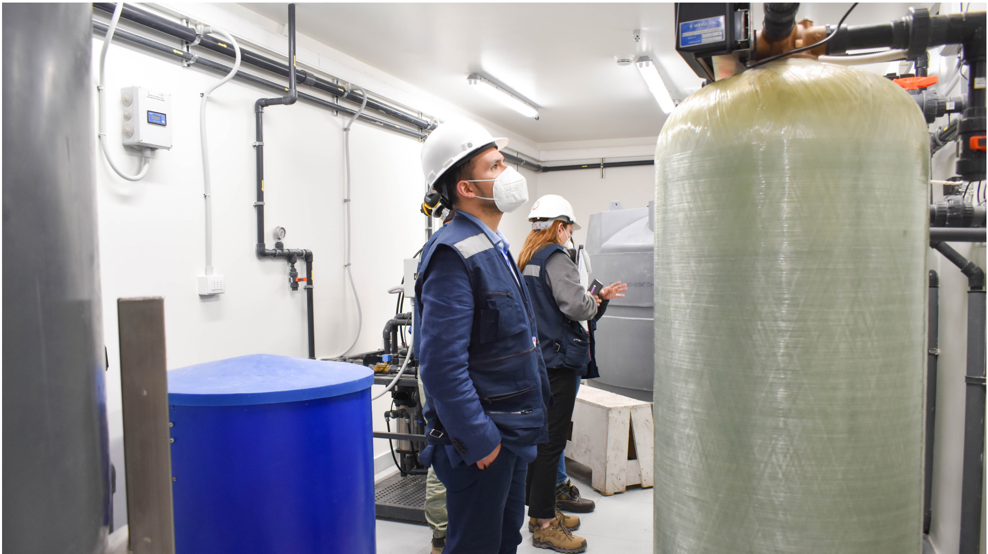
ALTA PUREZA. Desde el Hospital Carlos Van Buren destacaron la planta de tratamiento de aguas de Diálisis NHCV, ya que generará un agua con alto estándar de calidad mediante un desionizador.
